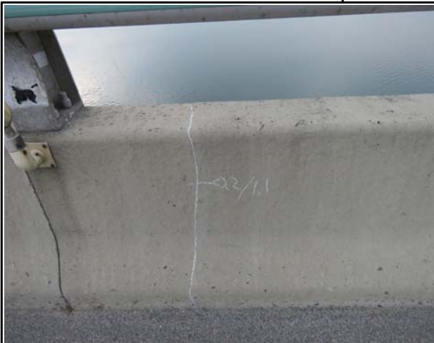
내 용 S7 방호벽 균열(CW=0.2)
