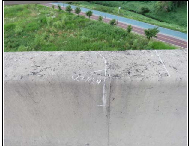
내 용 S4 방호벽 균열(CW=0.2)
