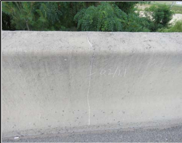
내 용 S1 방호벽 균열(CW=0.2)
