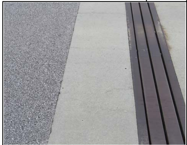
내 용 S3 후타재 균열(CW=0.2) 8EA
