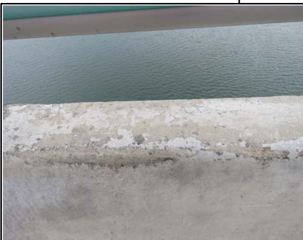
내 용 S12 방호벽 보수재 들뜸 및 박리
