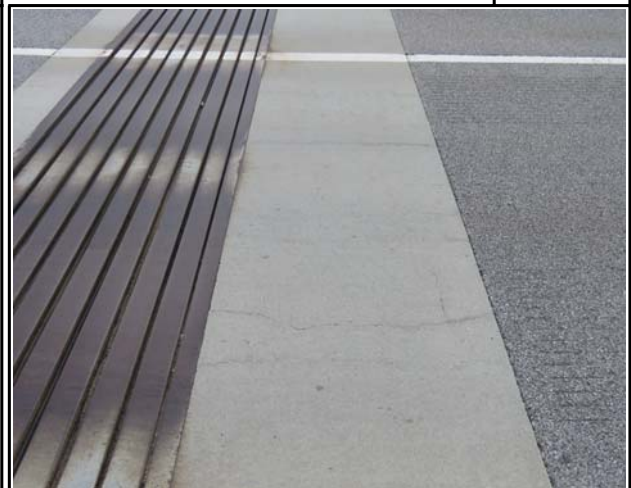
내 용 S15 후타재 균열(CW=0.3) 10EA
