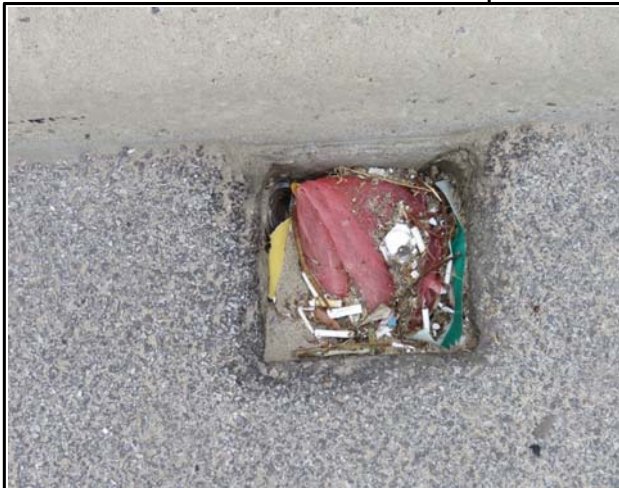
내 용 S8 배수구 이물질 퇴적
