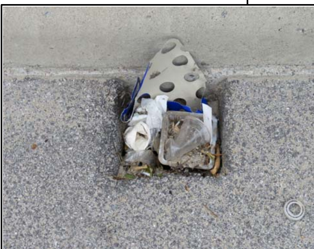
내 용 S11 배수구 이물질 퇴적
