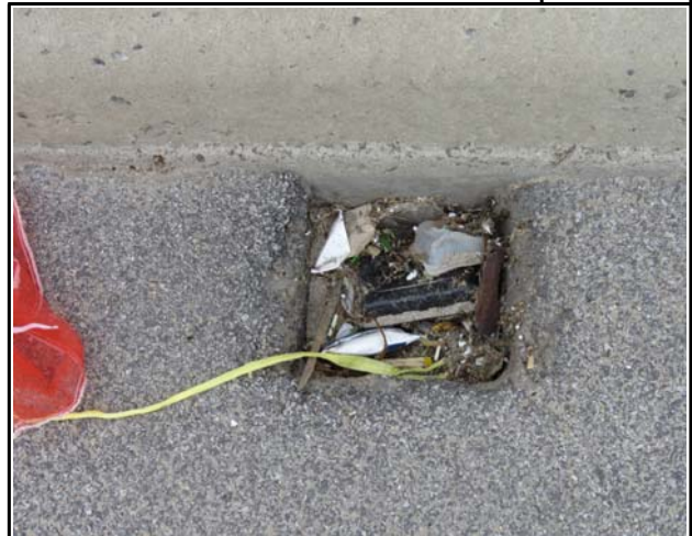
내 용 S9 배수구 이물질 퇴적
