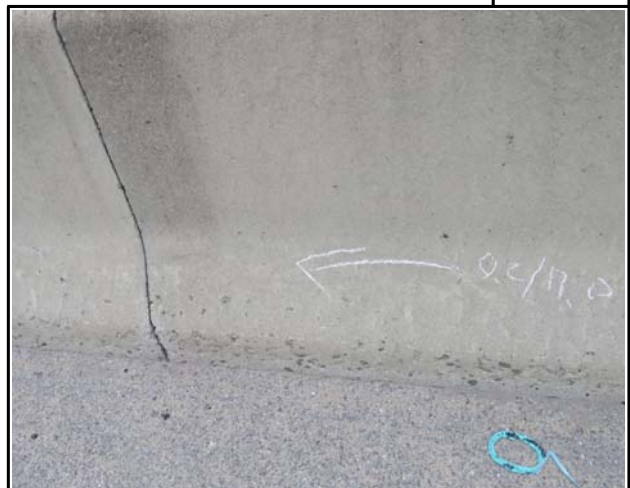
내 용 S14 방호벽 균열(CW=0.2)
